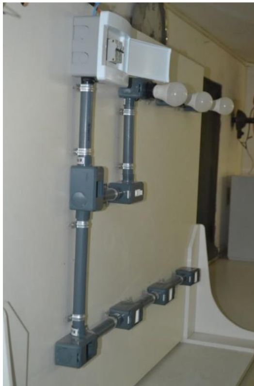
Figura 6– Foto da vista lateral do painel de instalações elétricas
